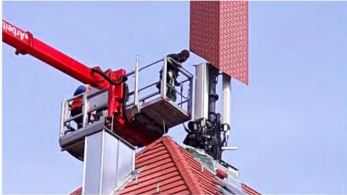
Ein Sendemast: Arbeiter verkleiden auf einem Wohn- und Geschäftshaus eine Mobilfunksendeanlage mit einer Schornsteinattrappe. (Quelle: Kilian Moritz/dpa-bilder)
